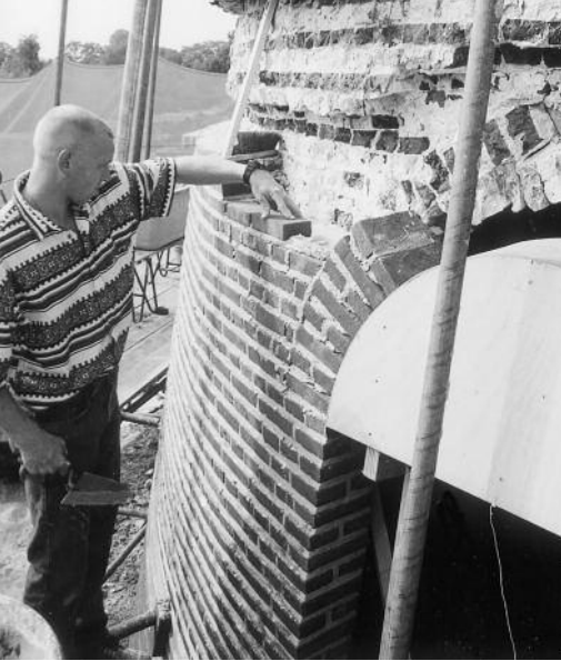
De metselaar (Aann.bedrijf Nijland te Linteloo) aan het werk aan de Sevink Mölle te Meddo (foto W. Vaags).
