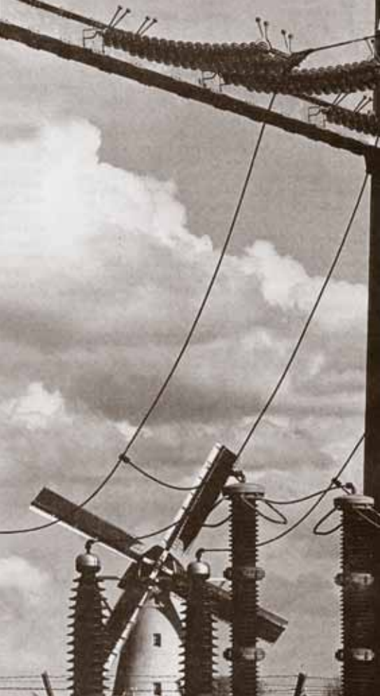
▲Doorkijkje op de molen van het transformatorstation. De bouw ervan werd de aanleiding tot het installeren van een elektromotor in de molen.
