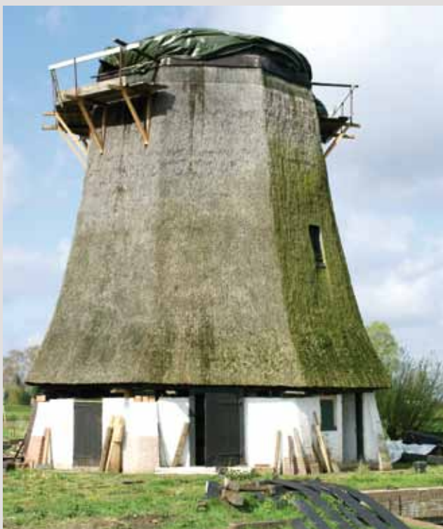
▲ De scheefstand is nog duidelijk zichtbaar, maar de fundering is al gestabiliseerd en de metselaar weet met de rest wel raad.
