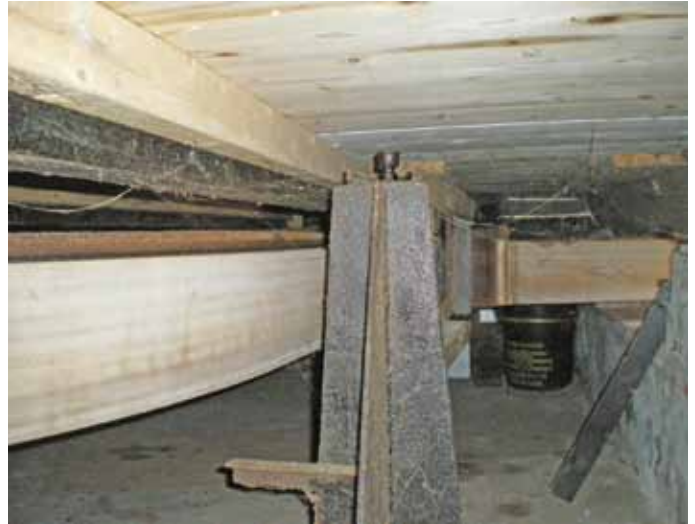
▲De riemaandrijving van de schroefpomp (foto Andries Veloo, 26 april 2012).
