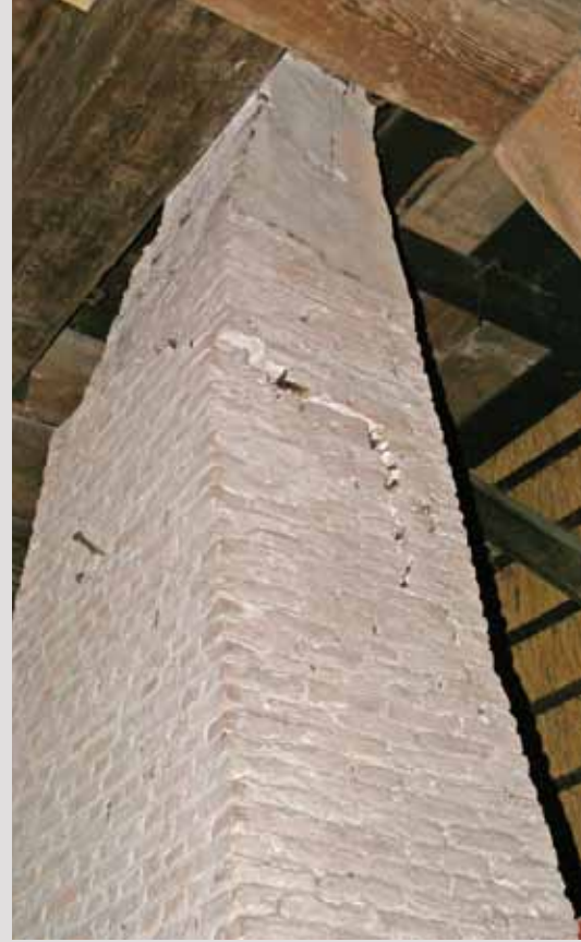
▲ De gemetselde schoorsteen is gekraakt.
