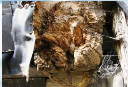
▲ Achter plaatijzer verborgen gebrek van het linker voeghout.
