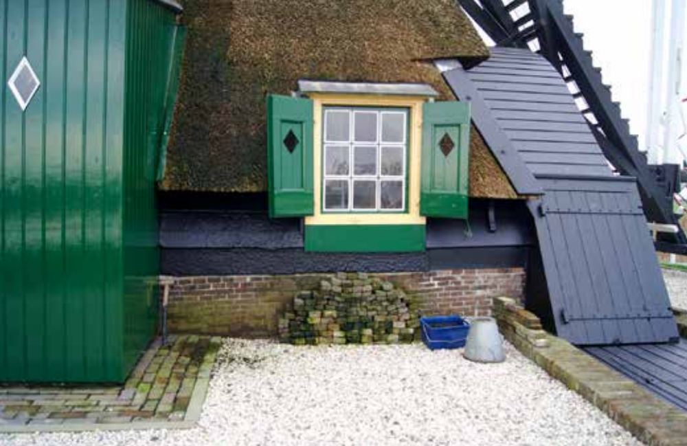
In 1852 transformeert B. de Vries uit Wilnis de molen weer terug naar zijn gedaante als traditionele wipmolen. De problemen zijn niet direct verholpen. Door zetting blijft de ingeboete veldmuur nog lange tijd verzakken en scheuren (foto auteur, 28 december 2020).
