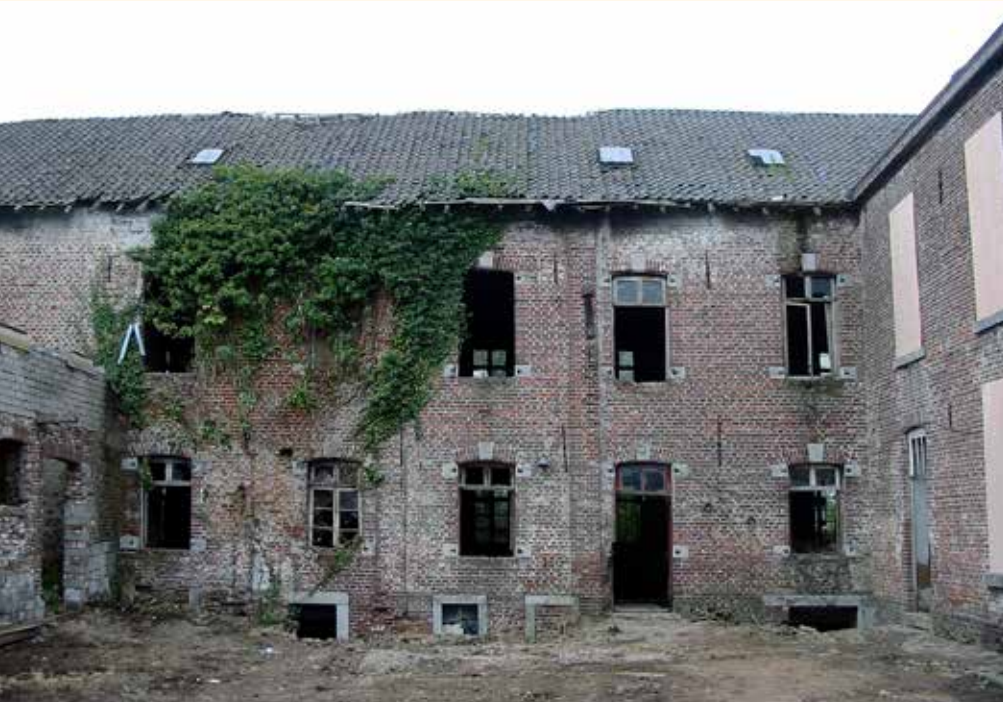
Beter dan met dit beeld van het hoofdgebouw vanaf de binnenplaats kan de staat van verval haast niet aangegeven worden (foto Res Nova Monumenten, Don Rackham, 12 oktober 2007).
